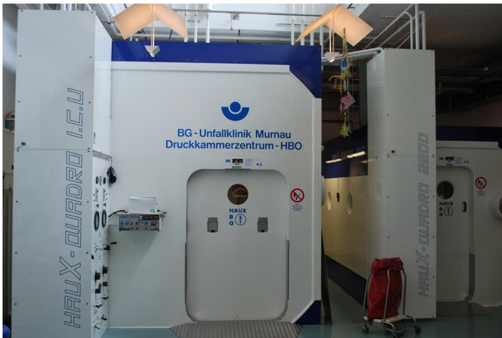
Abbildung 1: Das Druckkammerzentrum der BG Unfallklinik Murnau mit den beiden Druckkammern; links im Bild die große Kammer HAUX QUADRO I.C.U. mit Platz für zwei Intensivbetten inklusive benötigter Ausstattung oder 10 sitzende Patienten, rechts im Bild die kleine Kammer HAUX QUADRO 2200 mit Platz für 6 sitzende Patienten
